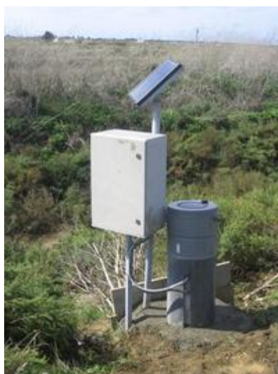
Piézomètre équipé d'un GSM pour interrogation à distance à l'Epine.
